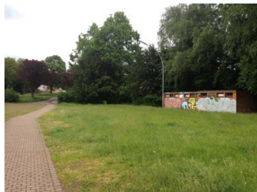
Abb.9) sanierungsbedürftige öffentl. Toilettenanlage
